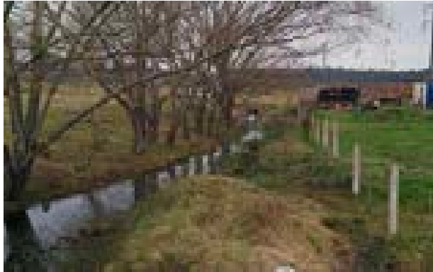
Foto 1: Alcantarilla de cruce Los Cedros (ingreso de la cañada a la pieza)
