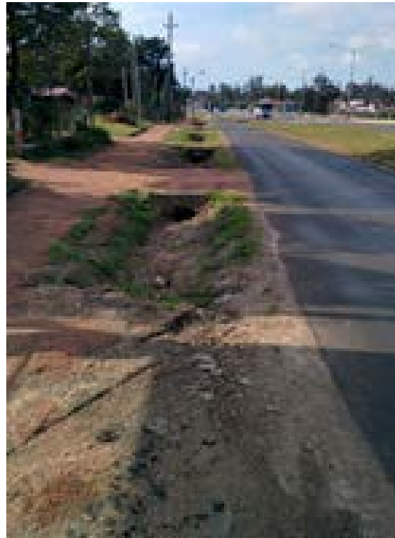
Foto 16: Cunetas erosionadas calle paralela norte a Ruta Interbalnearia
