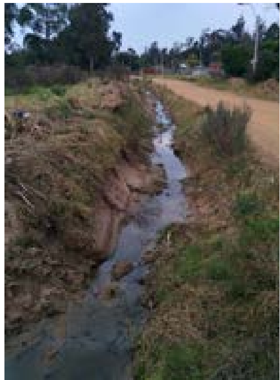
Foto 9: Conducción final por cuneta este de calle 12
