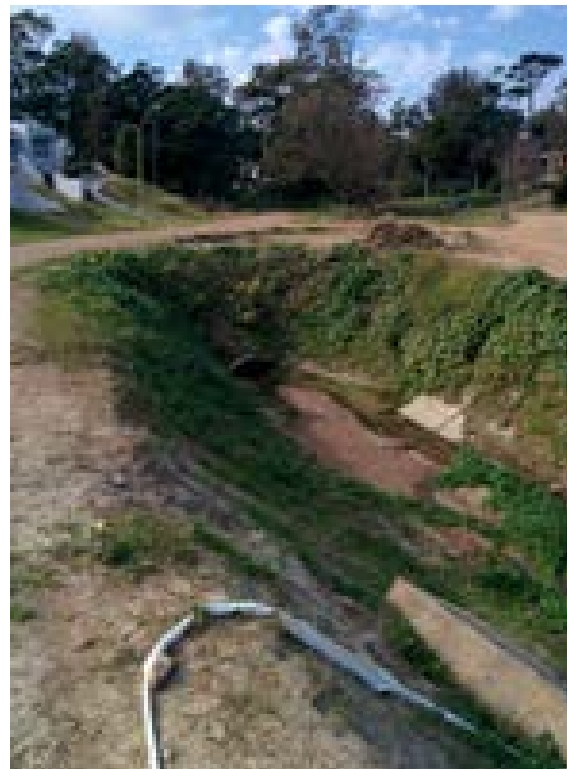
Foto 36 Alcantarilla aguas abajo de la anterior totalmente sedimentada y sin cabezal
