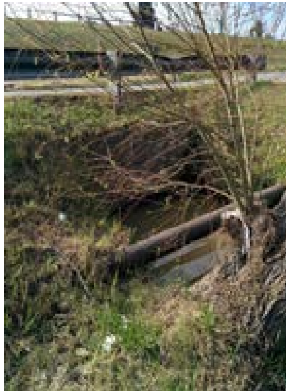
Foto 32 Alcantarilla de entrada al Cañadón Ciruelos del Japón
