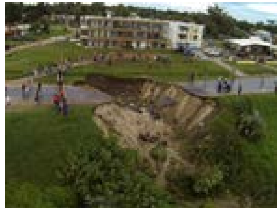
Foto 45 Derrumbe de la rambla febrero 2014, foto subrayado.
