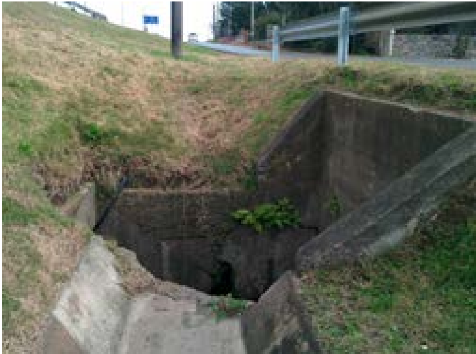
Foto 14: Cámara de cruce bajo Ruta Interbalnearia
