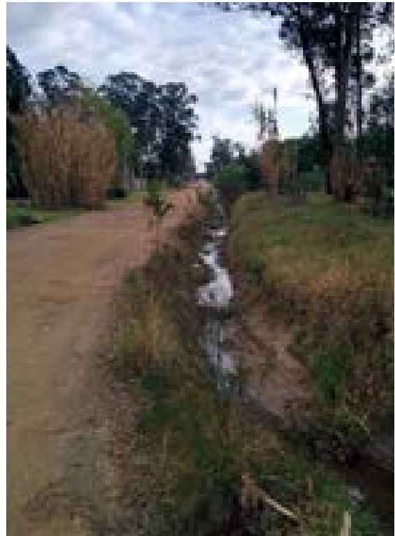
Foto 7: Cuneta empastada aguas abajo del canal de la foto anterior.
