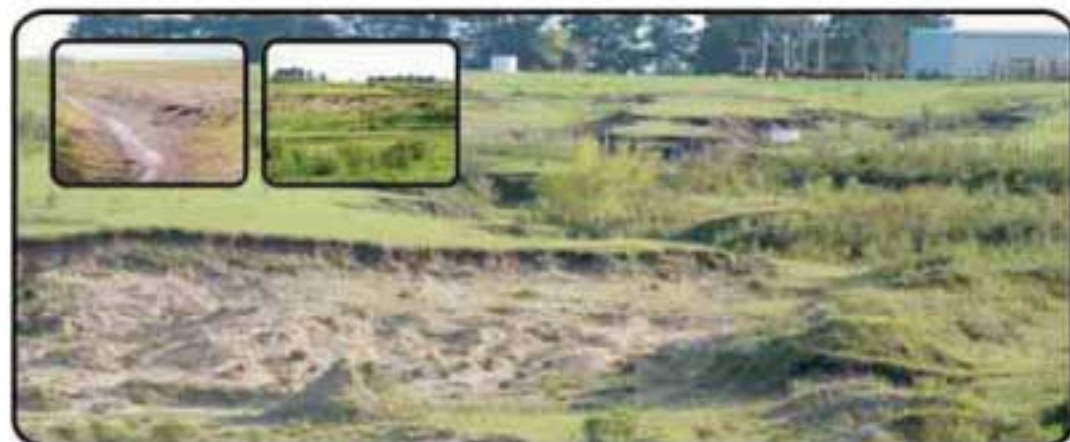
Imágenes de erosión en diferentes predios del departamento
